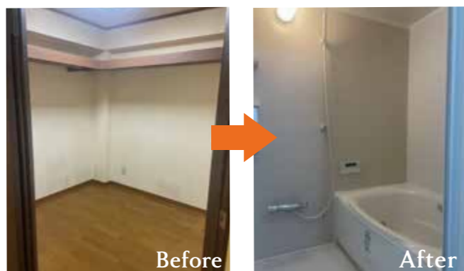
ウォークインクローゼット WICを半分のスペースにし、ユニットバスへ
